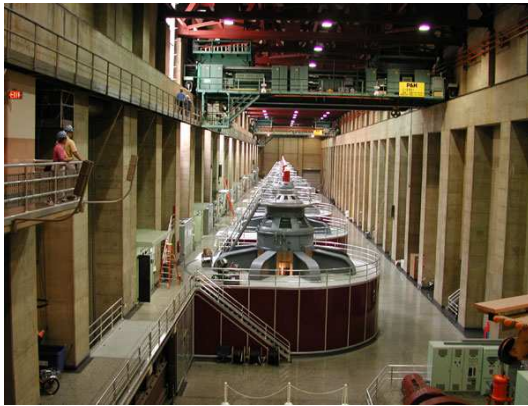
ภาพที่ 1-10 เจนเนอเรเตอร์ภายในโรงไฟฟ้า ที่มา : http://dic.moohin.com/g/generator
